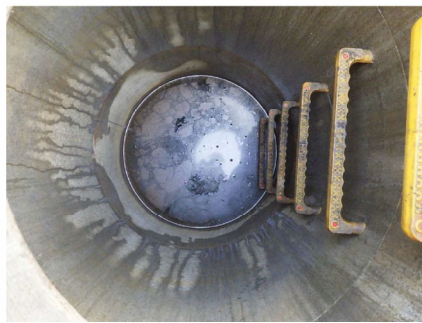
図4 マンホール内の滞水状況
