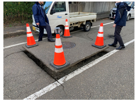
図6 マンホールの浮上状況
