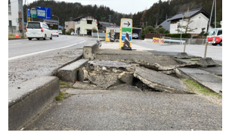
図11 歩道部の被災状況
