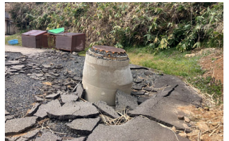
図13 マンホール浮上
