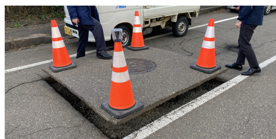
マンホールの浮上状況
