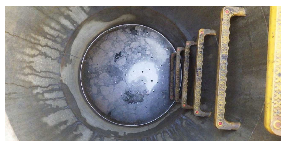
マンホール内の滞水状況
