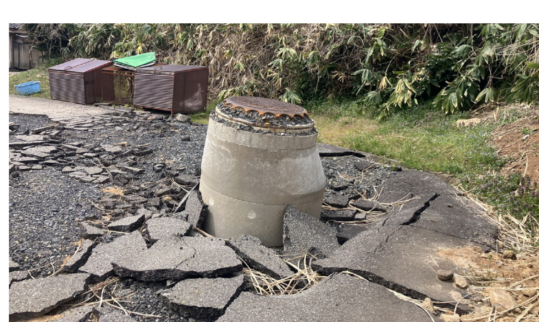
マンホール浮上
