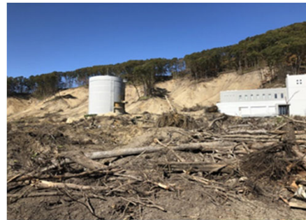
図2 北海道厚真町浄水場被災状況 (北海道胆振東部地震)
